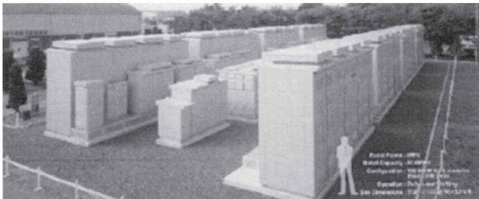
Рис. 1.35. Батарея мощностью 57,6 МВт·ч (8 МВт) для выравнивания нагрузки, установленная в Японии компанией NGK [54]
